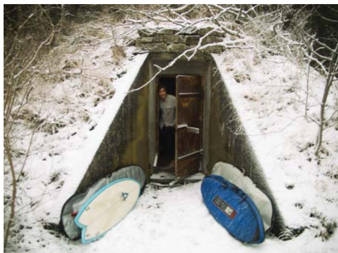
Ombyte i bunker nr 310 nedanför Saharaområdet. Byggnaden har använts som ammunitionsförråd men blir öppen året runt som offentlig värmestuga. Vedspis installeras samt ny glasad entrédörr innanför befintlig ståldörr.
