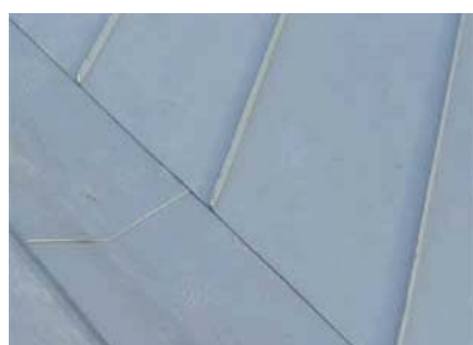
Falsad zinkplåt, sk. förpatinerad mörk grå, svart eller mörk grön. Plåten kan även vara målad dessa färger.
